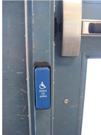
B1a power door control
